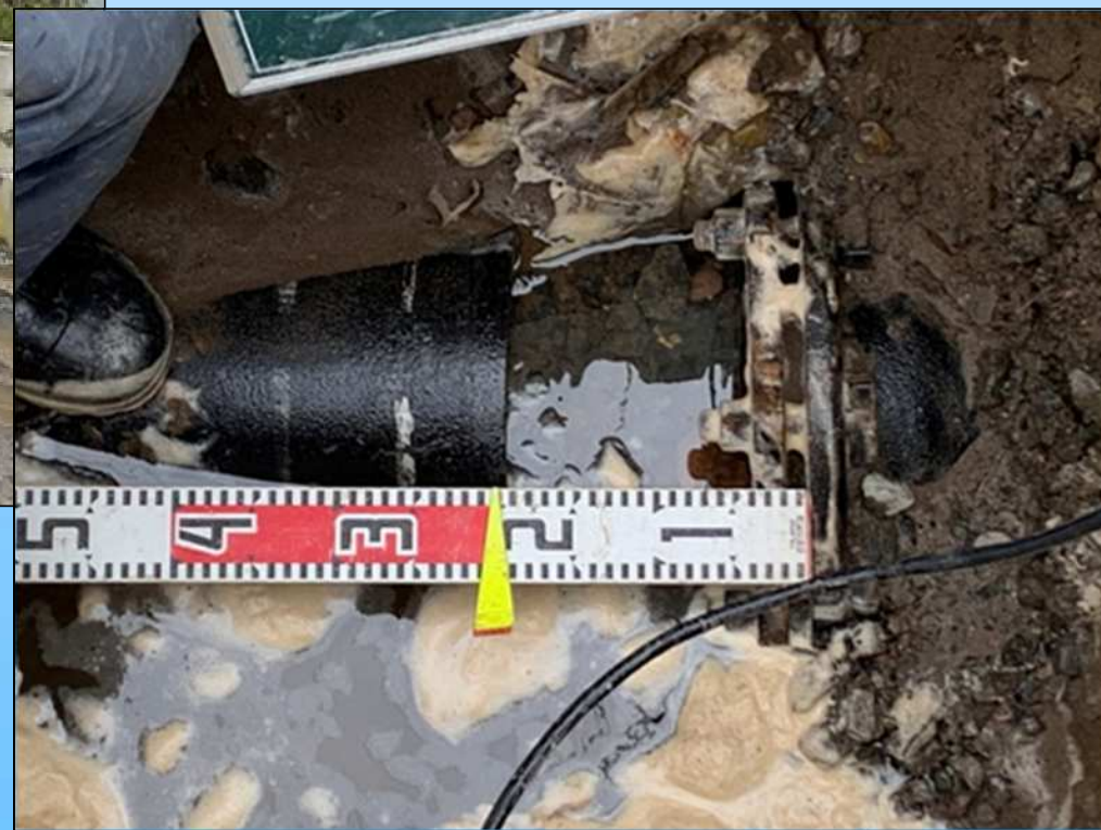
管の破損(抜出し)
