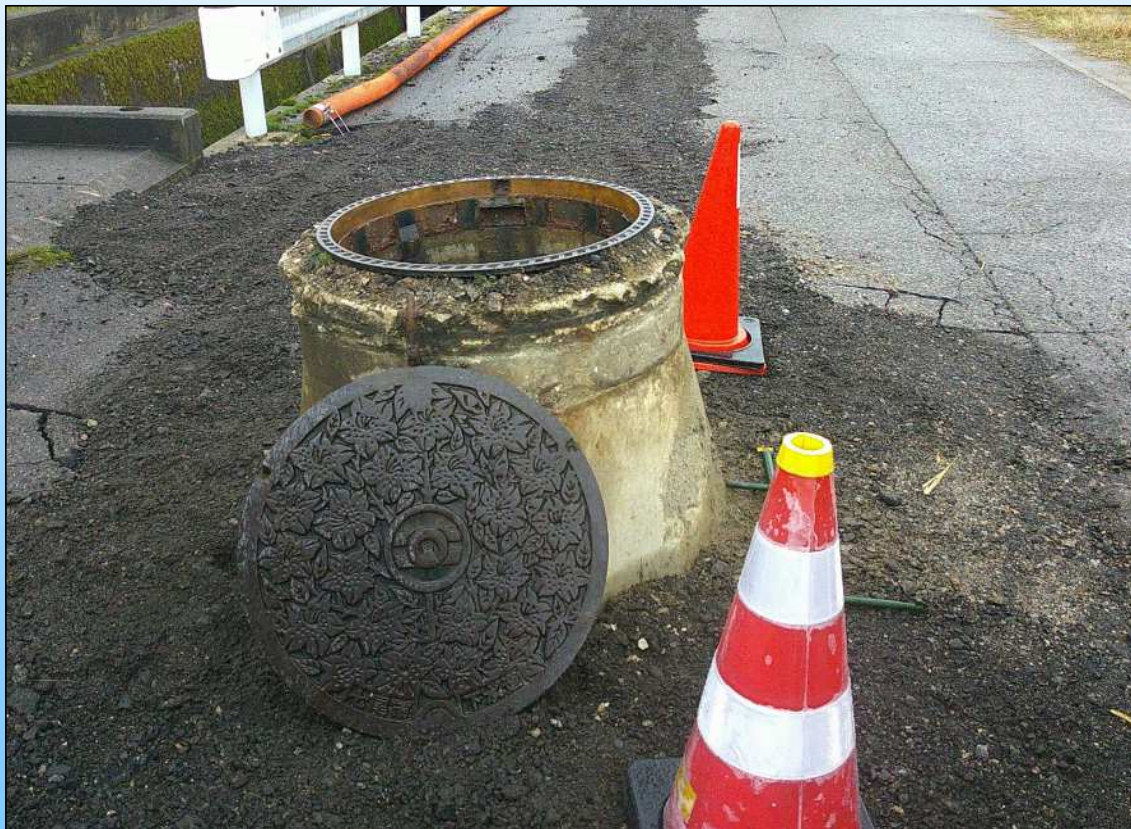
マンホールの浮上
