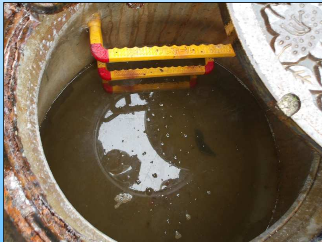
マンホール内の滞水
