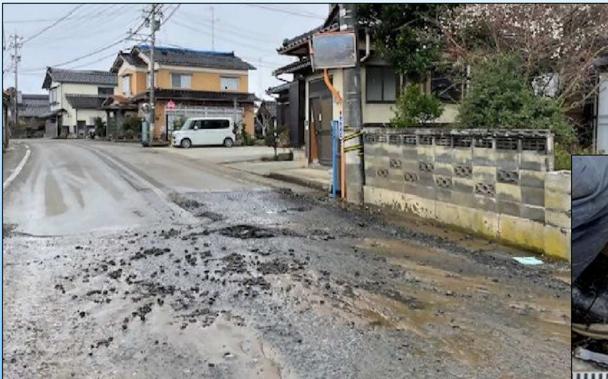
浄化センターへ汚水を送水する管からの漏水
