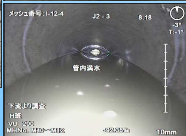
カメラ調査画像 (継手ズレ、滞水)
