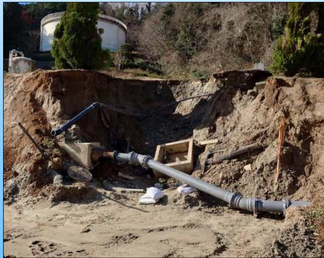
浄水場内埋設管の露出
